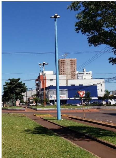
Figura 50. Arranjos específicos (Avenida Parigot de Souza) – Postes com três luminárias
